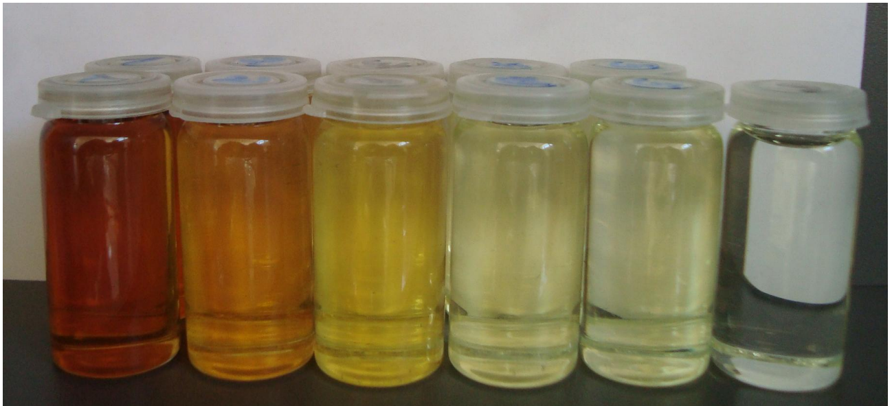
Bild 3: Verlauf der Ölqualitäten einer mobilen Öl - Regeneration an einem 25MVA / 50kV EKZ Reguliertrafo im Mai 2011
