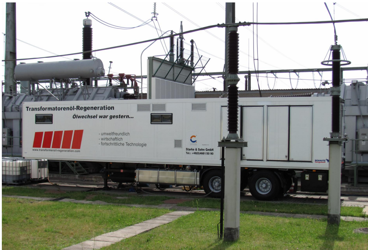
Bild 2: Mobile Regenerationsanlage im Einsatz
