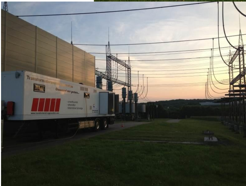
Bilder 1 & 2: MRA 4x4 Regenerationsanlage im Umspannwerk Linde der Amprion GmbH
